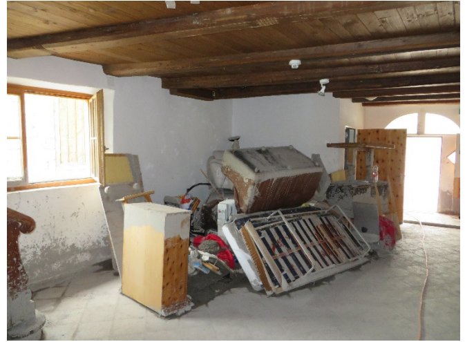
Bild 3: Verschlammtes Mobiliar wurde in der Eingangshalle gestapelt und musste entsorgt werden.
