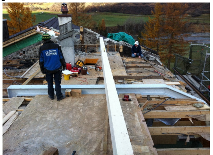
Bild 15: Der Stahlträger übernimmt seine Funktion als Haupt-Lastenträger des neuen Dachstuhls. Im Hintergrund beobachtet Heiri Schmid die Arbeiten.
