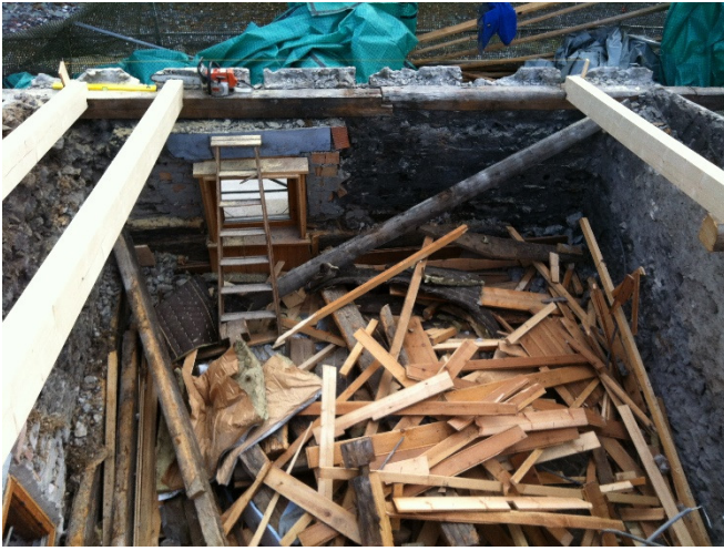
Bild 16: Die Aufrichte des Dachstuhls beginnt beim Zimmer Lischana, dessen Täferung der Wände kurz vorher weggerissen wurde.
