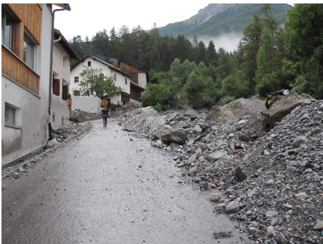
Bild 6: Die Strasse zwischen Haus und Bach nach gelitten. der Grobräumung!
