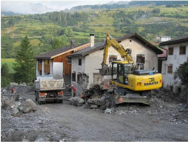
Bild 2: Nachdem die Autos abtransportiert waren, wurde das angeschwemmte Material mit Baggern auf Camions verladen und weggeräumt.
