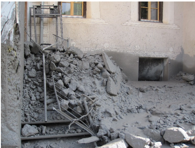
Bild 4: Der völlig zugeschüttete Kucheneingang...
